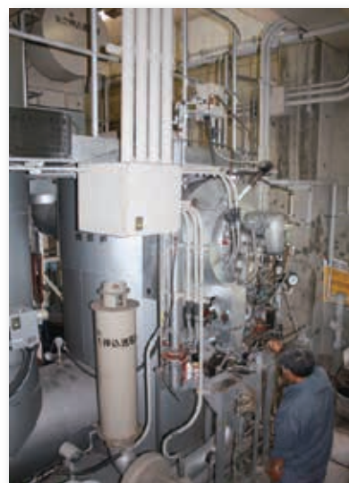
焼却炉の保守点検
