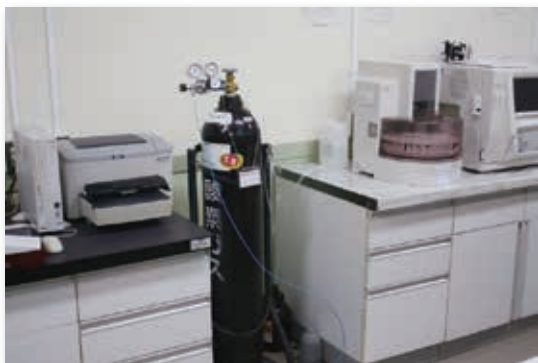
ガスボンベの設置（2箇所チェーン固定）
