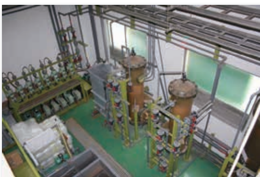
フッ素吸着樹脂塔と水銀吸着樹脂塔
