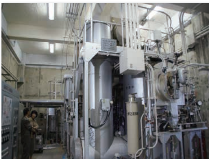
有機廃液処理焼却装置
