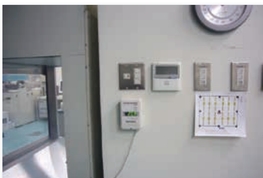
酸素濃度計の設置
