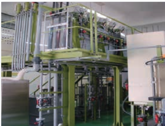
無機廃液処理装置（鉄粉法）
