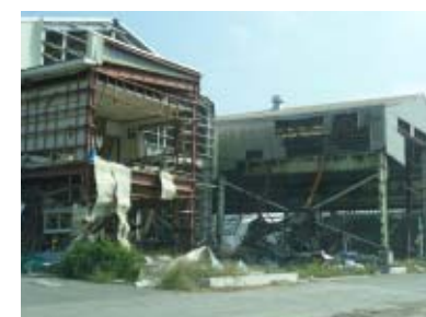
海岸の生産設備が壊滅（石巻市）
