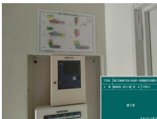
自動火災報知設備
